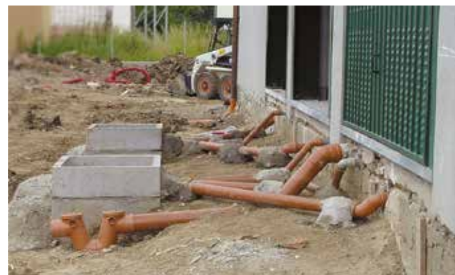
Esempio di installazione di sifoni AN all'esterno dell'abitazione
