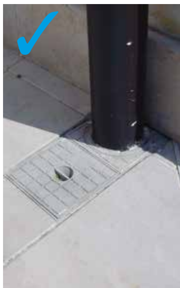
Pozzetto pluviale corretta installazione
